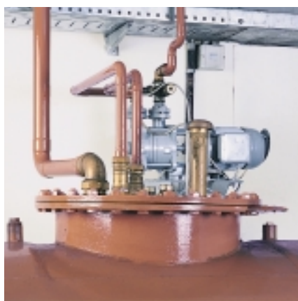
Системы заправки резервуаров мазутного/дизельного топлива.
